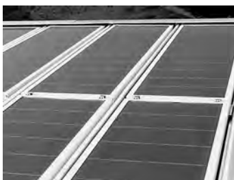
Abbildung 9: Dachfläche mit integrierten Fotovoltaikmodulen.
